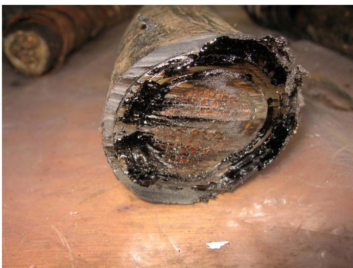
Figuur 4: Voorbeeld van een kabel met kunststofomhulling en -isolatie met aanhangende olie- of teerverontreiniging (Bron: RIVM-briefrapport 609021097)
