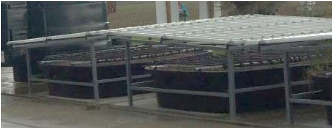
Figuur 8.4 Voorbeeld van een opvangvoorziening voor met gewasbeschermingsmiddelen vervuild restwater.
