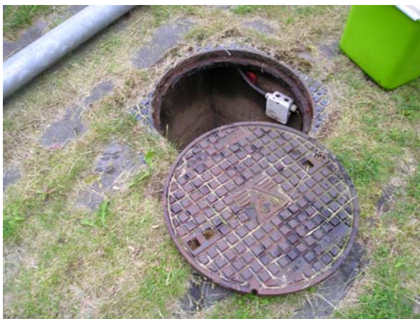
Ondergronds opslagreservoir voor opgevangen regenwater
