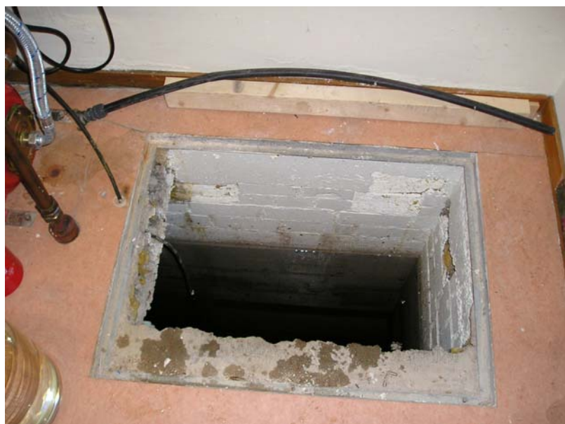
Opslagreservoir voor opvangen regenwater, aangebracht onder het pand, buiten de isolatieschil, van binnenuit bereikbaar
